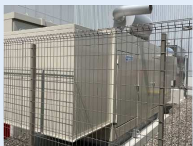
非常用発電機
