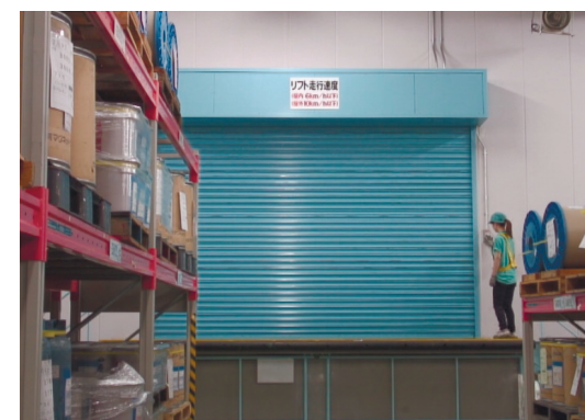
冷気漏れを防ぐ物流センターの電動シャッター
