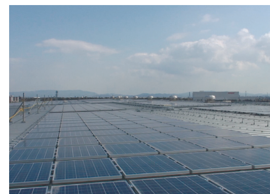
太陽光発電パネル(刈谷中央物流センター)
