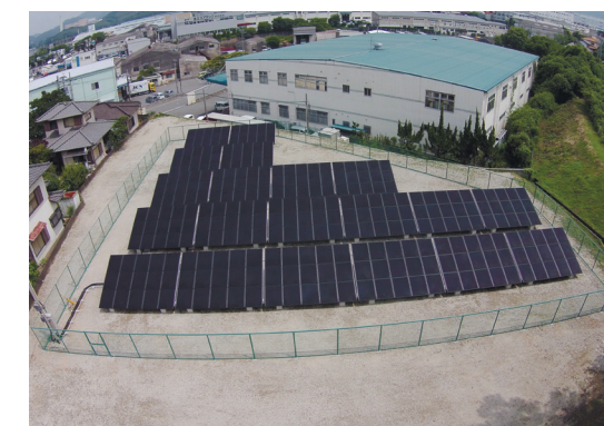
遊休地に設置した太陽光発電(福岡)
