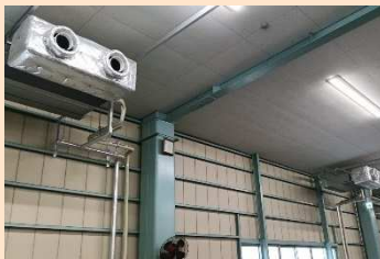
倉庫内の空調設備
