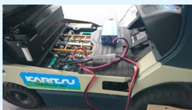
非常用電源装置
