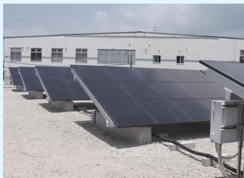
福岡県太陽光発電パネル
