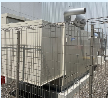
非常用発電機
