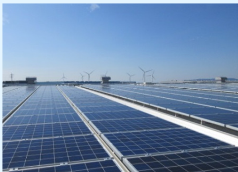
田原物流センター太陽光発電パネル
