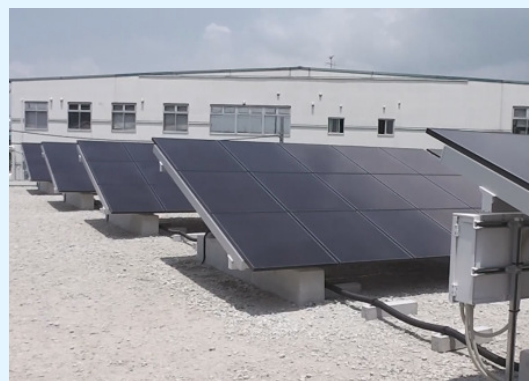
福岡県太陽光発電パネル
