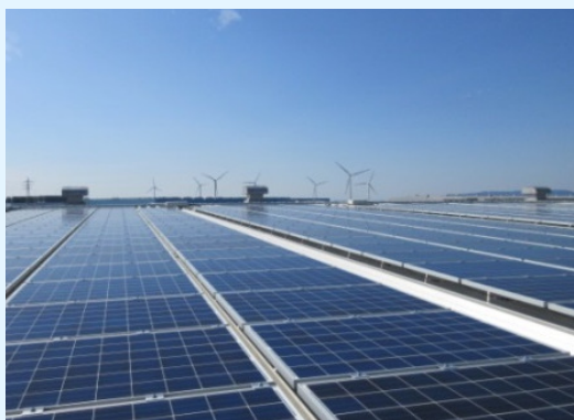
田原物流センター太陽光発電パネル
